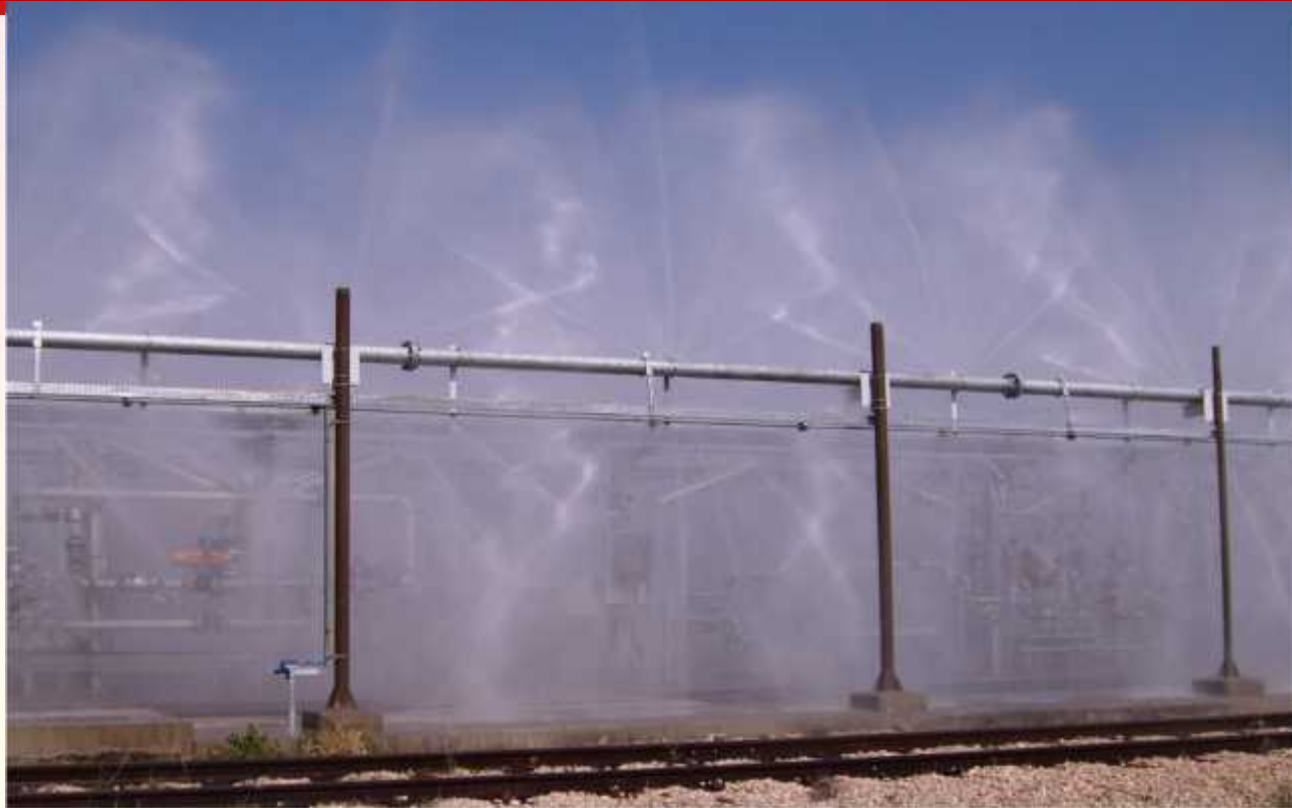
Rideau d'eau –barrière thermique entre deux postes de chargement rail
