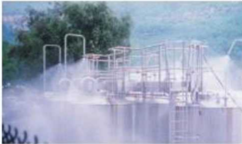
Installations brouillard d'eau
