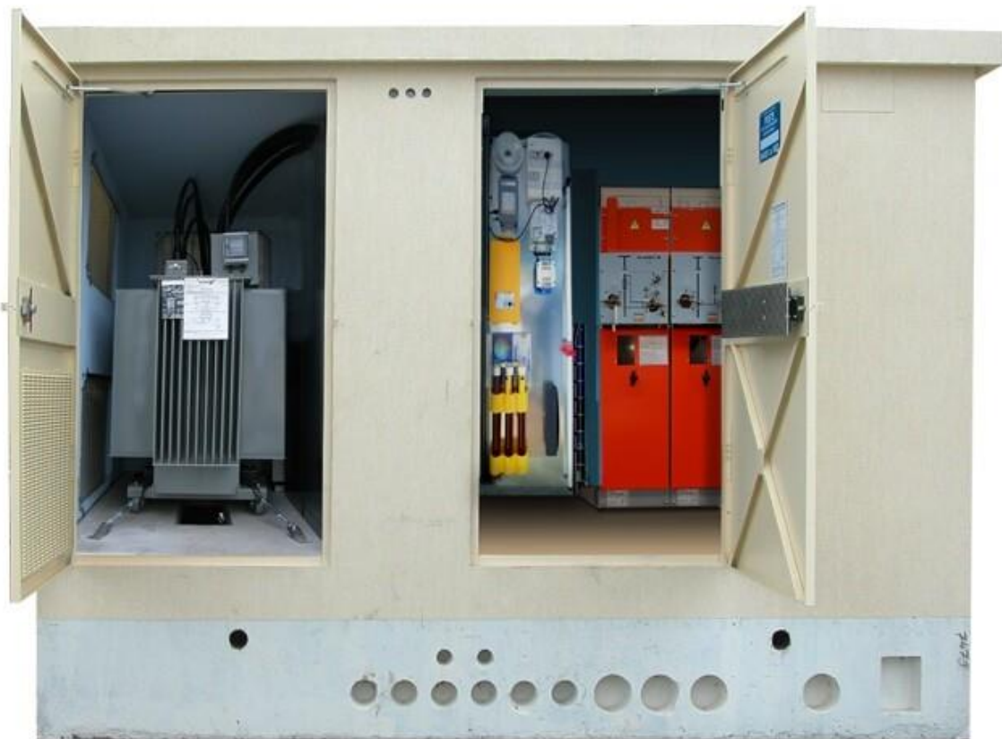
Fig. 4.10 : Poste de transformation HTA/BT
